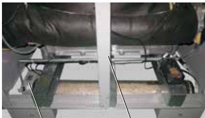
zariadenie na čerpanie kondenzátu
