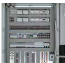
4 Kompletný systém MaR vrátane regulátora a ovládacieho panela, špeciálne navrhnuté pre bazénové jednotky
