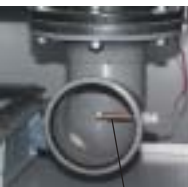
Abgastemperaturfühler im Kunststoffbogen
