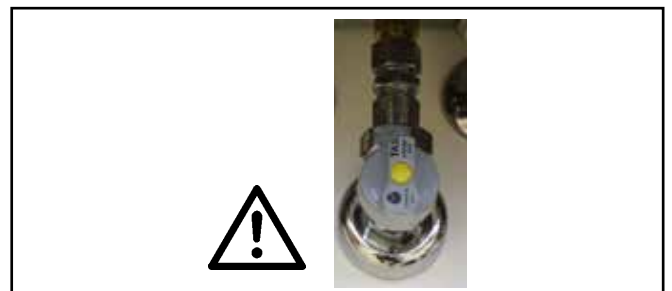
Bild: Gasanschluß: Gefahr von Vergiftung und Explosionsgefahr durch auströmendes Gas
