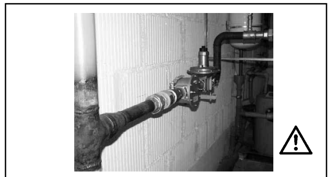
Bild: Gasanschluß: Gefahr von Vergiftung und Explosionsgefahr durch ausströmendes Gas.
